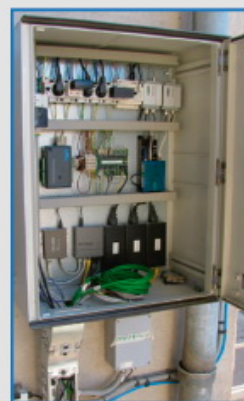
Электрощит с оборудованием для управления системой
